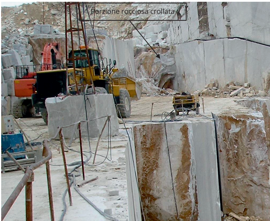
Foto 4 - ammasso roccioso alcuni giorni prima del crollo
