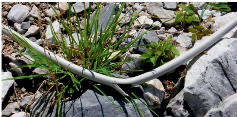
Foto 4 - cavo elettrico che presenta segni di rotture
