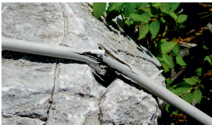
Foto 3 - cavo elettrico che presenta segni di rottura
