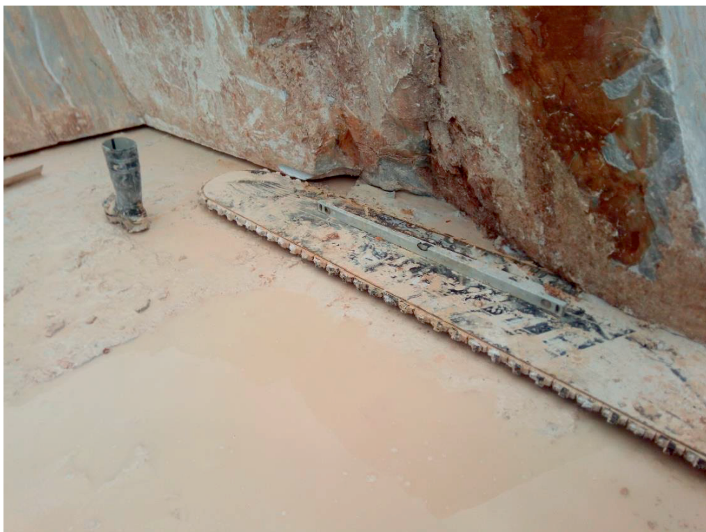
Foto 2 - vista del punto di accadimento dell'infortunio (in alto a sx, lo scarpone lacerato dell'infortunato, a destra la lama della tagliatrice a catena su cui è poggiata la riga con bolla, per il controllo della livellatura della lama)
