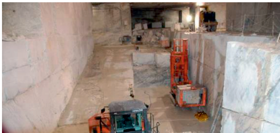
Foto 1 - fotografia rappresentativa del luogo di lavoro dopo l'incidente
