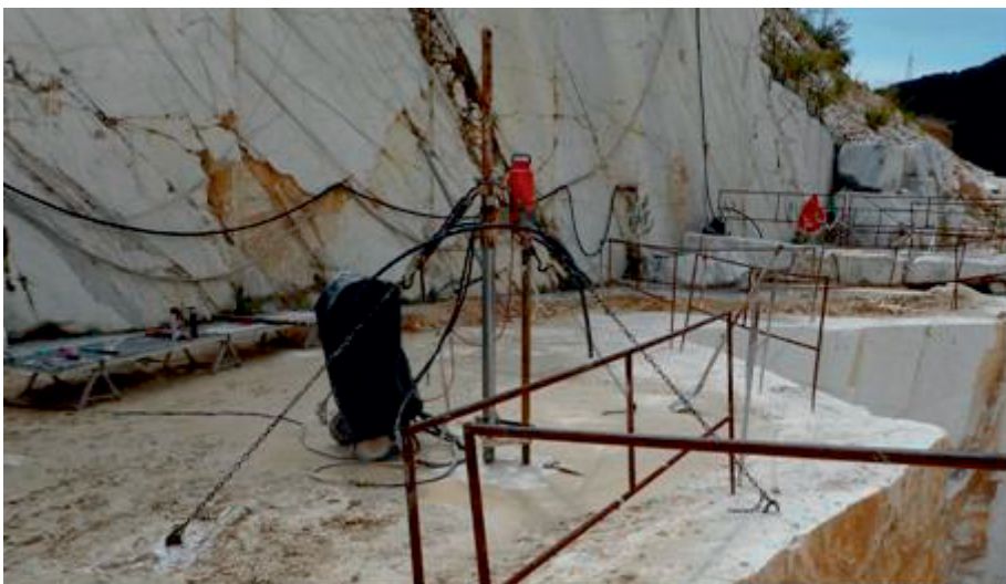
Foto 1 - vista del luogo di lavoro dopo l'incidente
