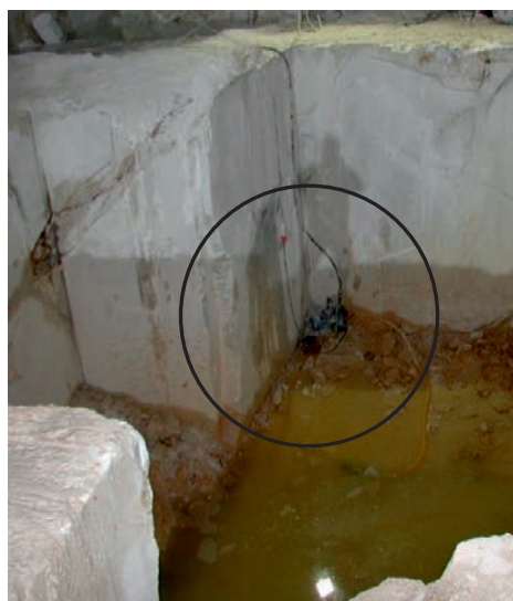
Foto 3 - pompa aspirazione acqua
