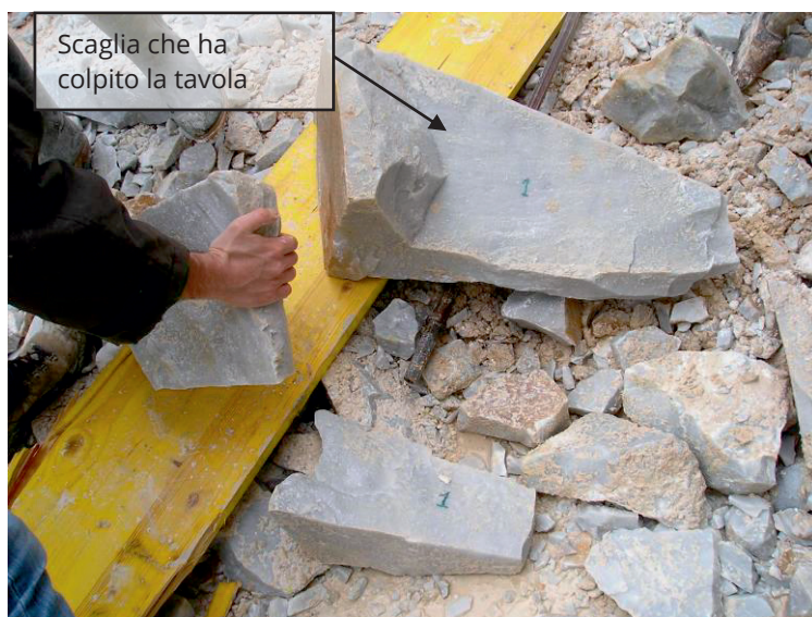
Foto 6 - particolare delle scaglie che hanno colpito i lavoratori
